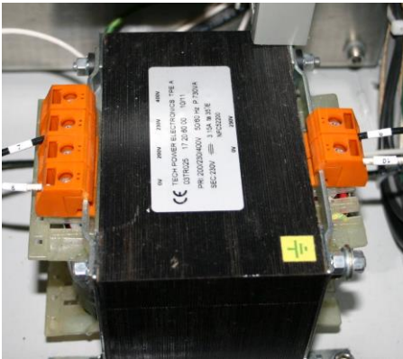
Transformateur d'isolement 400 V No: 660-000008
